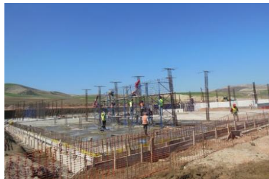
モロッコ 「フェズ・メクネス地域 上水道整備事業」 浄水場建設工事
